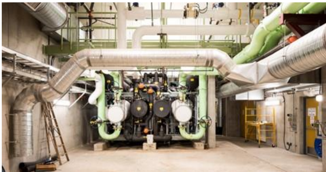
图 14.9 一个大型热泵（约 4 兆瓦）直接从过滤后的原始污水中提取热量，为东南福溪社区（位于坎库维尔市）服务
